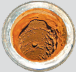
Rohr, drei Monate nach Einsatz des Hydrocleaners
