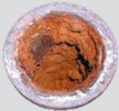
Altes, korrodiertes Rohr
