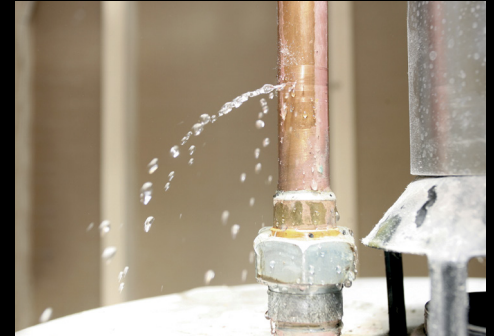
Bereits bei Kleinstleckagen wird die Wasserzufuhr von den BIOCAT KLS-Geräten abgesperrt.
