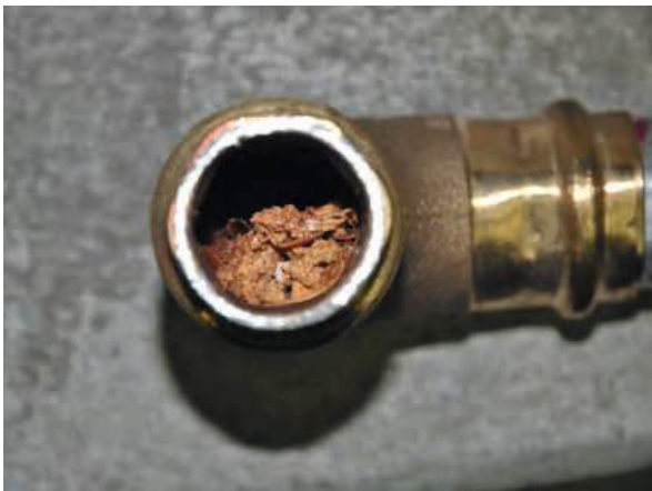
Speicherladeleitung vor Einbau der BIOCAT KS 14000
