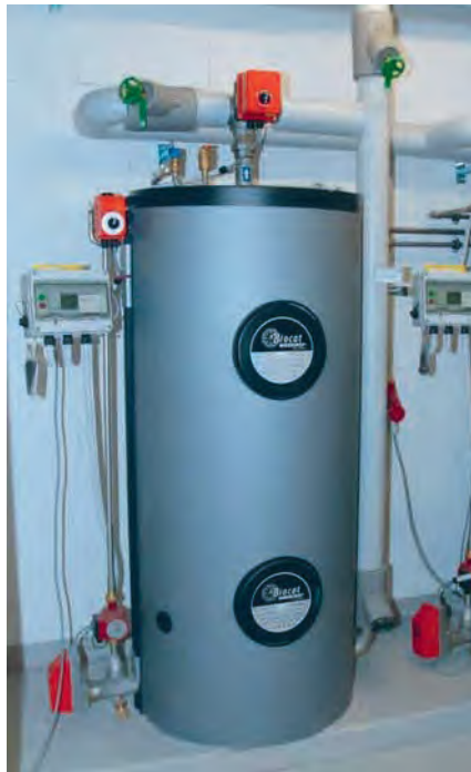
Zwei „KS 5 D“-Kalkschutzanlagen sorgen dafür, dass täglich bis zu 100 m 3 Trinkwasser über den natürlichen Prozess der Biomineralisierung kalkablagerungsfrei dem Trinkwassernetz entnommen werden können.
