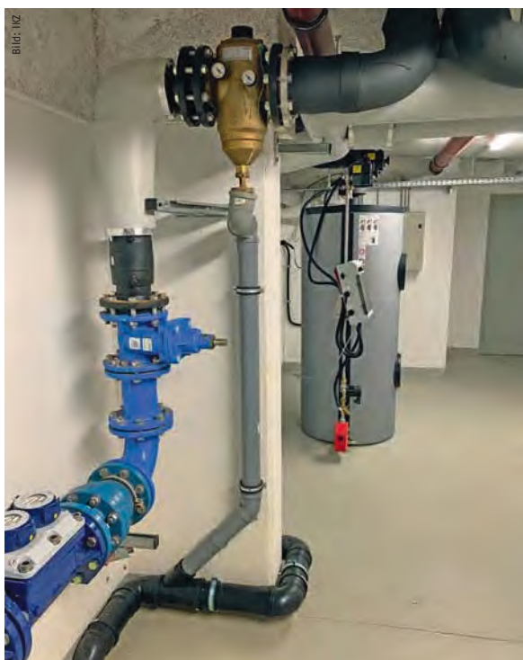
Die „Biocat KS 5 D“ wurde am Hauptwassereingang nach Feinfilter und Druckminderer installiert.
