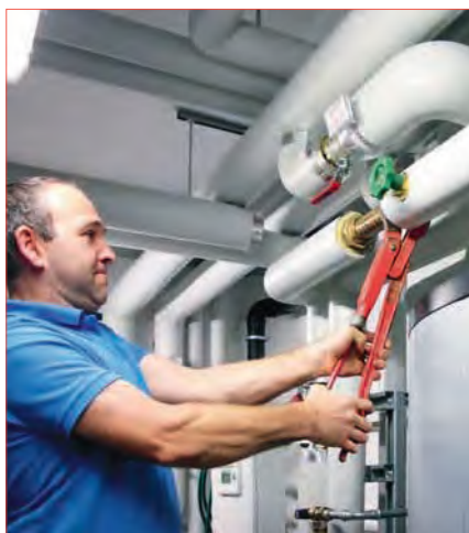
▶ Manfred Berger ist Hausmeister im Nesslerhof und betreut die Technik des Hotels in Großarl. Im Bild schraubt er gerade den Testabschnitt im Wasserleitungssystem auf, um das Rohrsegment herauszunehmen.
