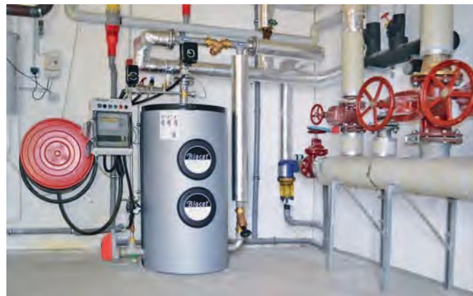
Installierte „Biocat“-Anlage. Sie bereitet das Wasser chemiefrei auf.
