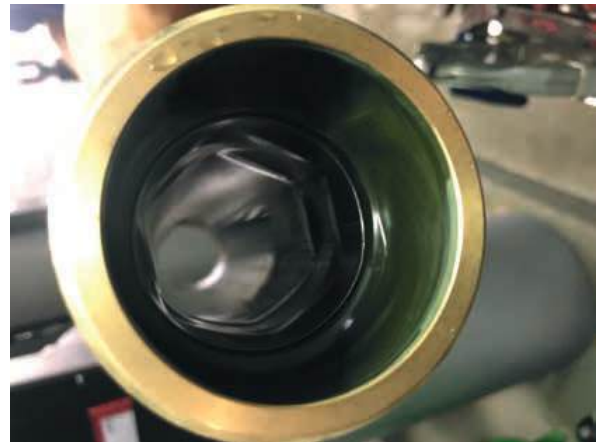
Speicherladeleitung nach 1 Jahr Betrieb
